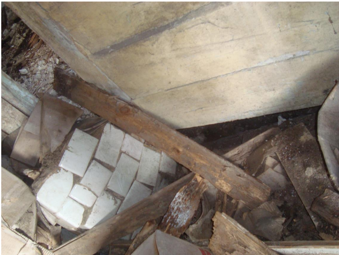
zapadnięta podłoga budynku
