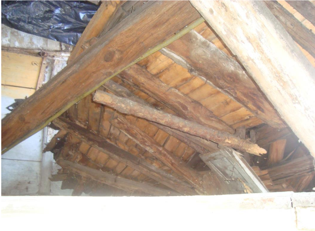
strop i dach w miejscu zawalenia
