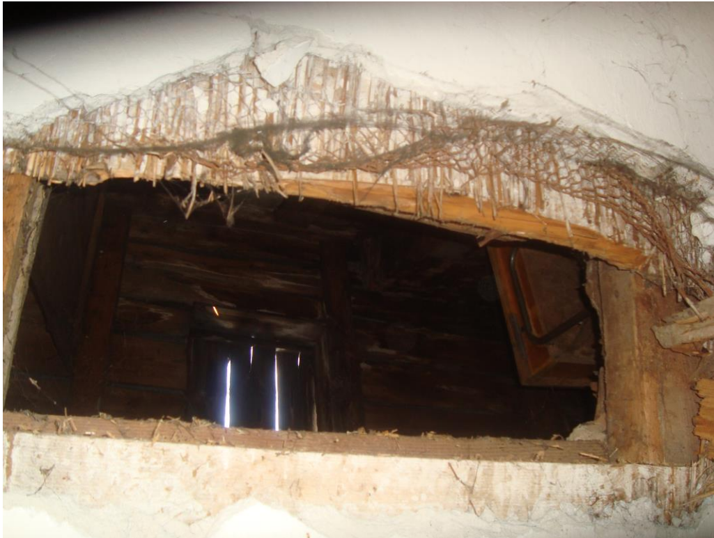
uszkodzona konstrukcja stropu
