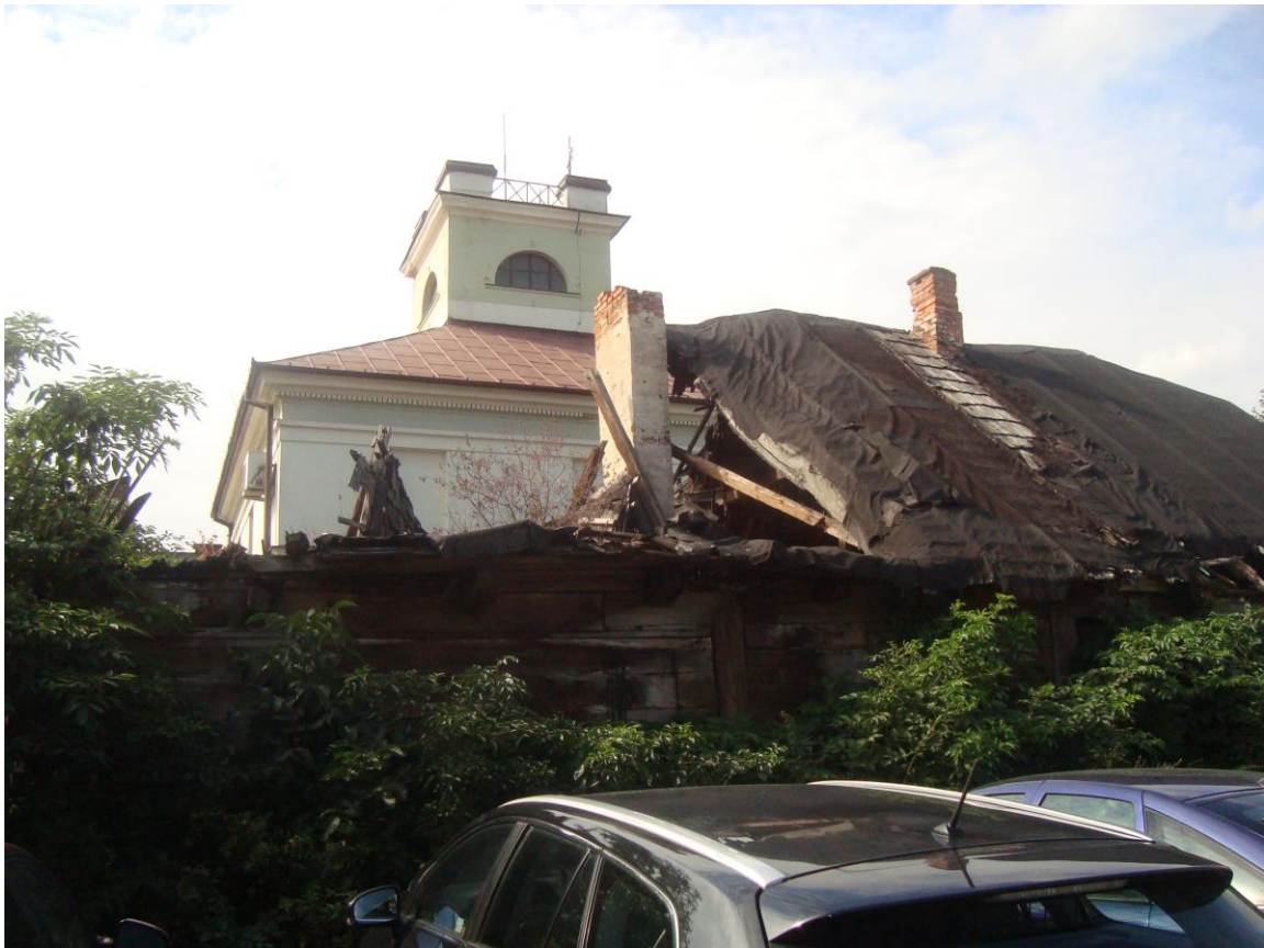
widok ogólny pozostałości połaci dachowej
